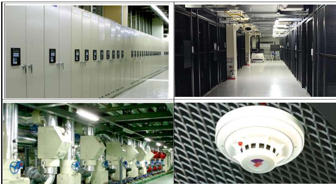
[그림 6-3-1-1] KT 강남 IDC 전원시설, 상면시설, 공조시설, 소방시설 현황
